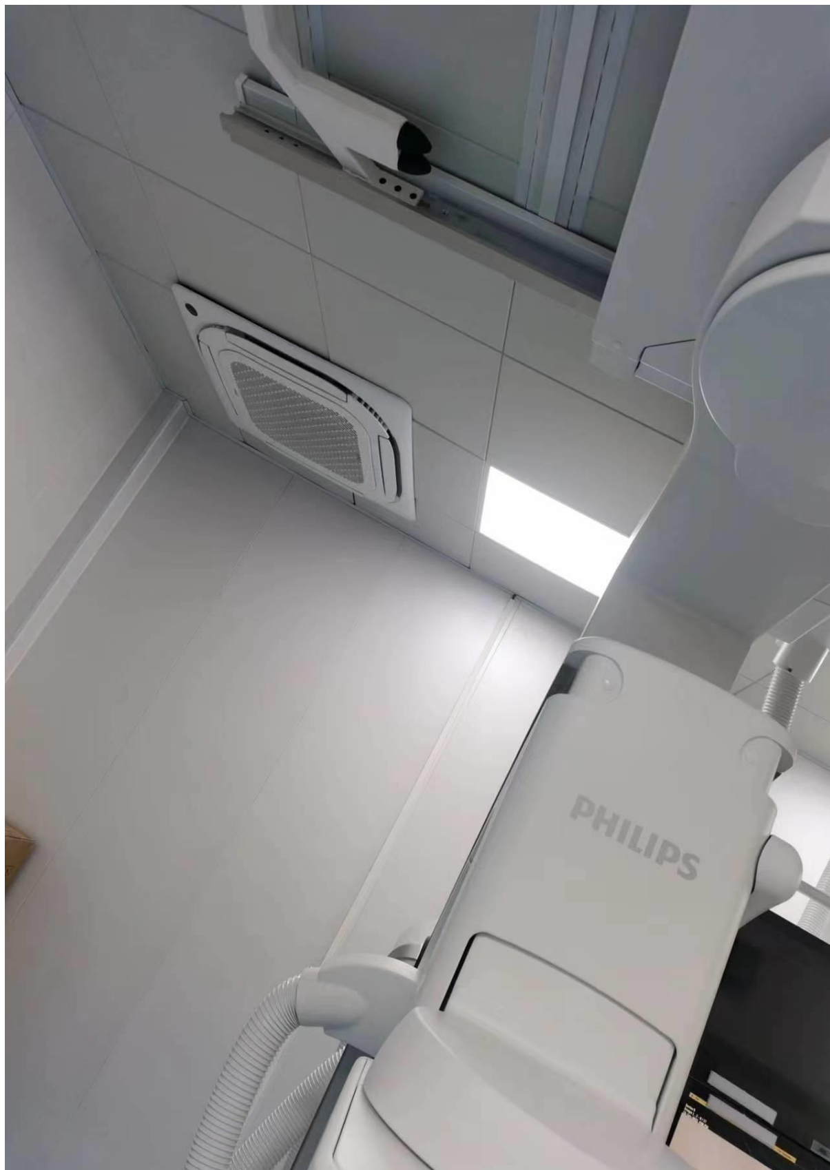
附件11：现场照片 通风装置
